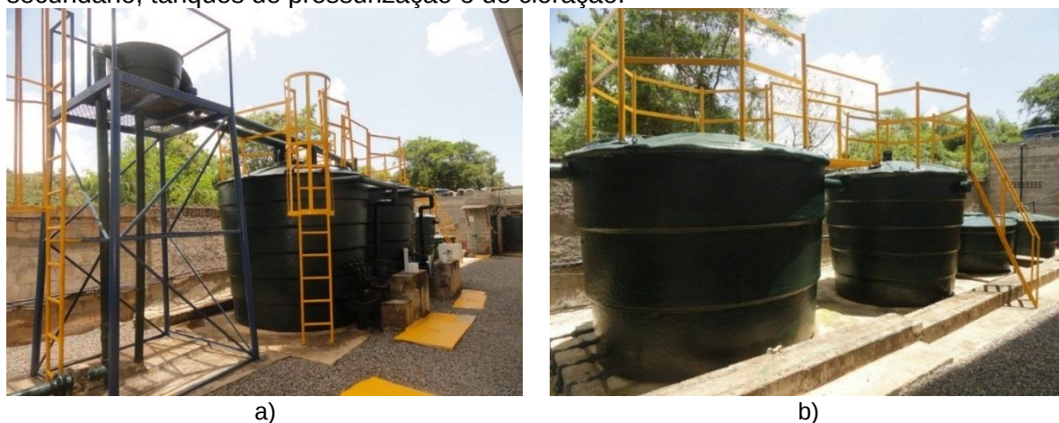
Figura 4.3 – Unidades constituintes da ETE: a) Caixa distribuidora de vazão, seguida por dois reatores anaeróbios em paralelo; b) Filtro aerado de leito submerso, decantador secundário, tanques de pressurização e de cloração.
