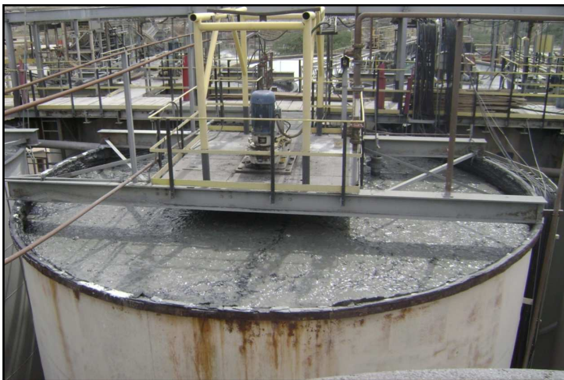
Figura 4.4: Detalhes do sistema de agitação dos tanques de lixiviação da MFB [Fonte: Mineração Fazenda Brasileiro]
