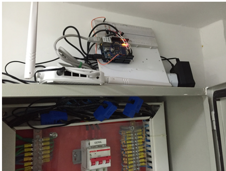
Figura 30 – Sensores de corrente e setup experimental instalado na loja 01
