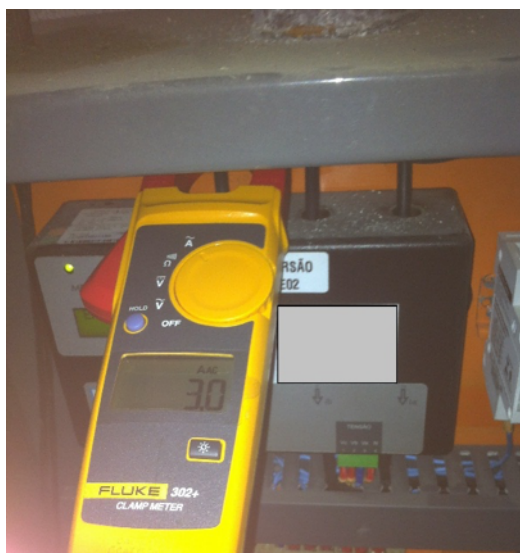
Figura 15 – Medição de corrente elétrica utilizando um alicate amperímetro
