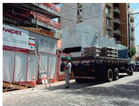
Figura 9b- Obstrução calçada 2
