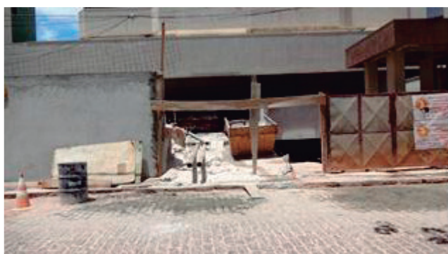
Figura 9a- Obstrução calçada 1
